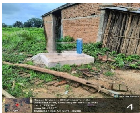
चित्र 4.2: वितरण लाईन के बिना निर्मित कार्यशील घरेलू नल कनेक्शन एवं बिना कनेक्शन के खुला पड़ा कम्पोजिट पाइप (ग्राम भिथीडीह बस्ती कमारडेरा)
