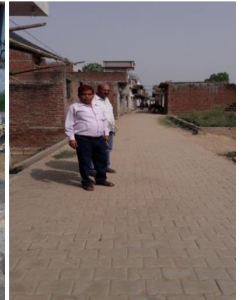
जनपद-सम्भल के क्षेत्र पंचायत बनियाखेड़ा द्वारा कराया गया कार्य अच्छी गुणवत्ता की इण्टरलाकिंग का सड़क निर्माण कार्य
