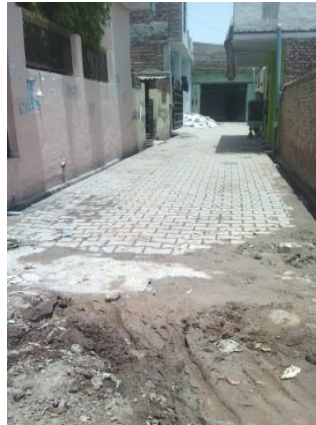
जनपद-मथुरा के क्षेत्र पंचायत मथुरा के ग्राम पंचायत महोली में ग्राम पंचायत द्वारा टूटी इण्टरलाकिंग का सड़क निर्माण कार्य
