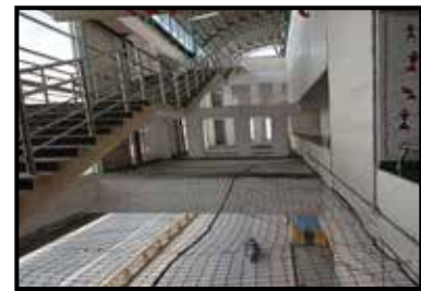
चित्र 11ख - नागासंद्रा स्टेशन पर सड़क के ऊपर खुले स्थानों की अनुचित ढंग से की गई कवरिंग
