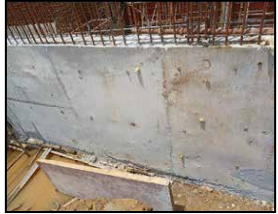
चित्र 9घ - बीआईईसी स्टेशन पर आरसीसी दीवार के निर्माण में खराब कंक्रीटिंग
