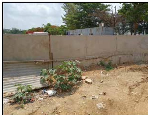
चित्र 10क - बीआईईसी स्टेशन पर रिटैनिंग वॉल की मधुकोशनुमा संरचना और असमान कंक्रीट सतह
