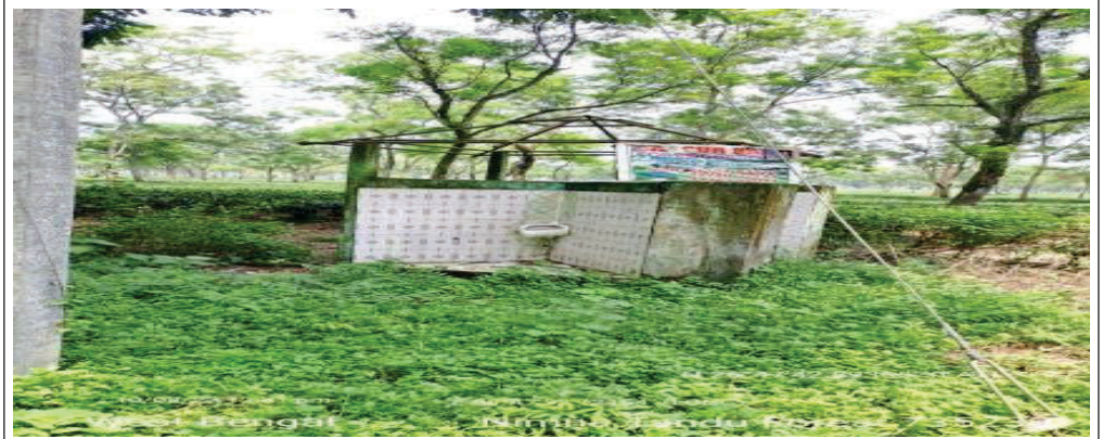
চিত্র 3.29 : জলপাইগুড়ির গরুমারা ফরেস্টে শৌচালয়ের জরাজীর্ণ অবস্থা
