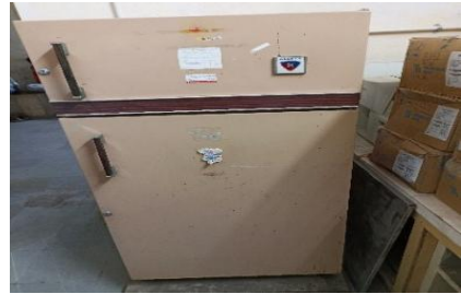
ఛాయా చిత్రం 5.19: అనంతపురము జీజీహెచ్ లో పనిచేయని శీతలీకరణ యంత్రం (2022 ఆగస్టు)
