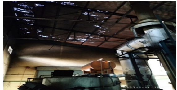
सी बी डब्ल्यू टी एफ हलद्वानी, नैनीताल की जर्जर टिन की छत
