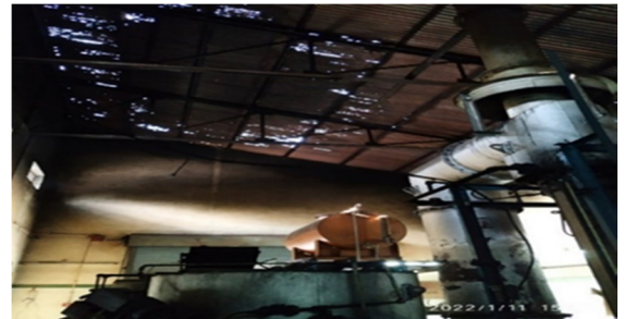
सी बी डब्ल्यू टी एफ हलद्वानी, नैनीताल की जर्जर टिन की छत
