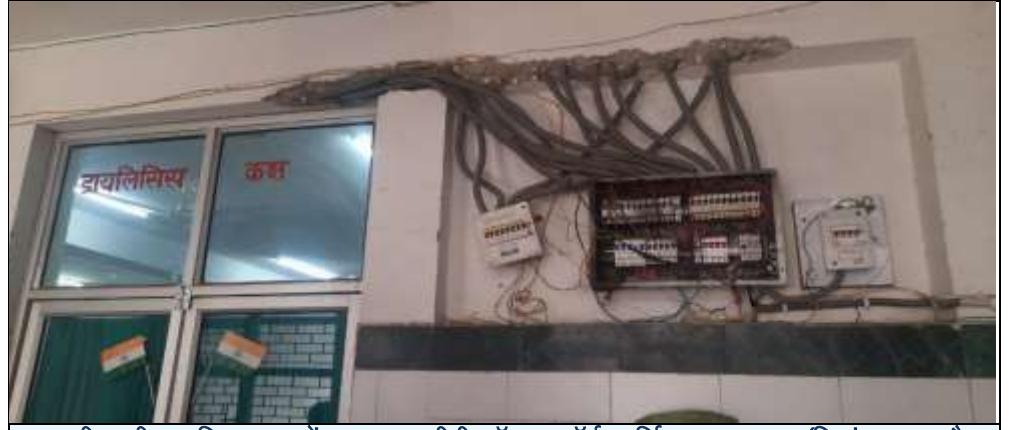
10. जीएमसीएच बिलासपुर में खुला एमसीबी बॉक्स, शॉर्ट सर्किट का खतरा (दिनांक 26 अप्रैल 2022)
