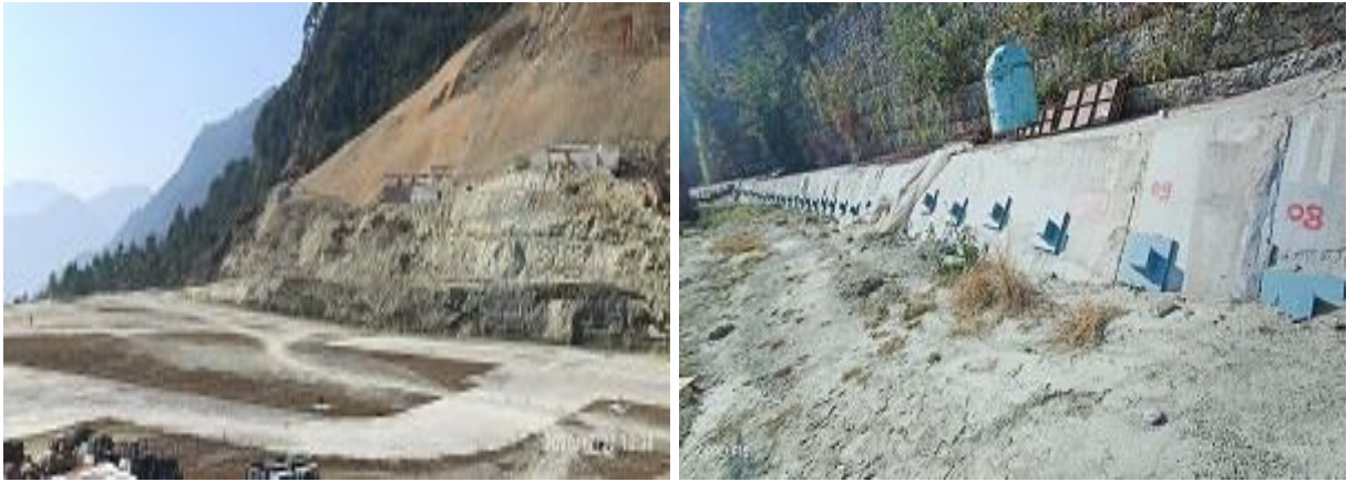
चित्र 1.4: कंक्रीट क्लैडिंग दीवार का चल रहा कार्य चित्र 1.5: रिटेनिंग वॉल के आधार को सुदृढ़ करने का चल रहा कार्य
