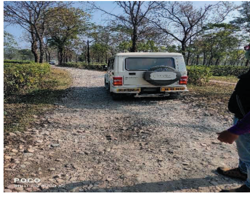
চিত্র 2.2: শামুকতলার কাছে অবস্থিত লালপুর থেকে 14 কিমি রাস্তার জীর্ণ বিটুমিনাস পৃষ্ঠ (20.12.2020)
