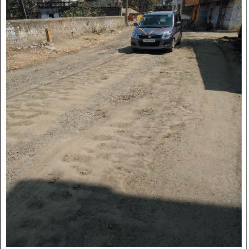
চিত্র 2.6: বীরভূম রাজপথ বিভাগ-I-এর অধীনে নলহাটি ভবানন্দপুর রাস্তার বিভিন্ন স্থানে সাবগ্রোভ উন্মুক্ত হয়ে আছে (27.02.2021)
