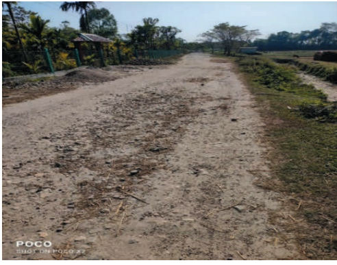
চিত্র 2.1: শামুকতলার কাছে অবস্থিত লালপুর থেকে 0.5 কিমি রাস্তার জীর্ণ বিটুমিনাস পৃষ্ঠ (20.12.2020)
