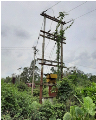
DTR (16 KVA) at Tipo kept idle/not charged
