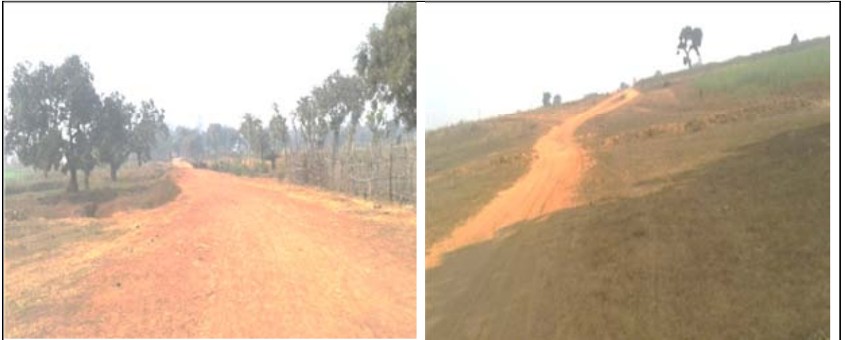
निजी भूमि का अधिग्रहण न होने के कारण रीवा जिले की रीवा सिरमौर सड़क से गारगिन टोला एवं राजगढ़ रोड के किमी 6/6 और का 6/4 पर अपूर्ण खण्ड का दिसंबर 2016 का दृश्य
