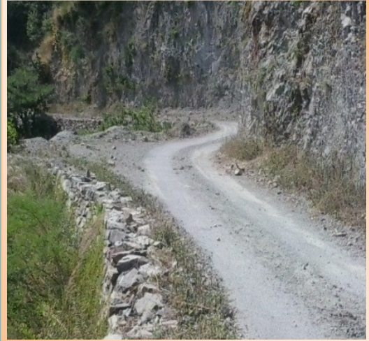
उत्तराखण्ड के नैनीताल जिला के भोरसा-पिनरो में सड़क निर्माण की घटिया गुणवत्ता
