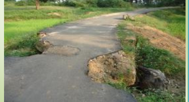
झारखंड के सिमडेगा जिला, में पंडरीपानी जलडेगा से पंडरीपानी तक सड़क की क्षतिग्रस्त पुलियां
