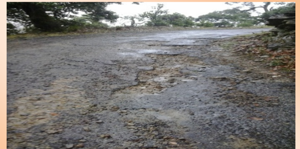
उत्तराखण्ड के पाँड़ी जिला में विभिन्न स्थानों पर मेलसेन से चोपडा तक सड़क का बिटुमेनी कार्य क्षतिग्रस्त पाया गया था।
