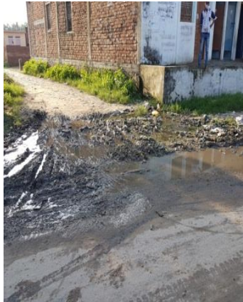
जनपद-जौनपुर के क्षेत्र पंचायत करंजाकला के ग्राम पंचायत द्वारा कराये गये कार्य टूटी इण्टरलाकिंग का सड़क निर्माण कार्य
