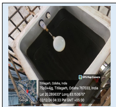
चित्र 3.1: टिटलागढ़ (पूतरे) में वाटर कूलर की पानी की टंकी में काला कीचड़ (अंकित किया गया है कि इसे 01.11.2024 को साफ किया गया था और 02.12.2024 को संयुक्त निरीक्षण किया गया था)
